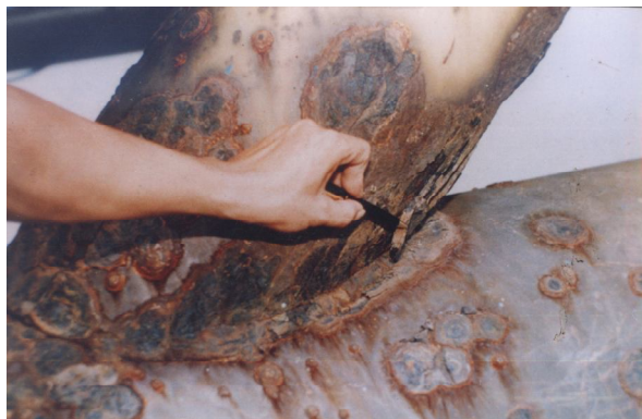
Hình 2. Tình trạng gỉ ở dầm cầu
