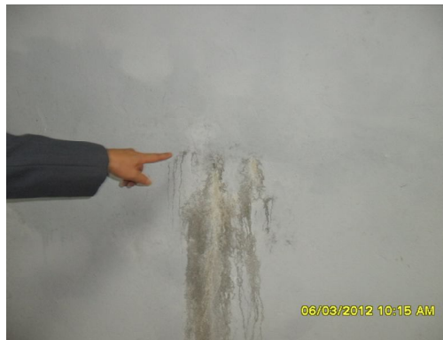
Hình 6. Thấm bể nước tại vị trí thi công mạch ngừng
