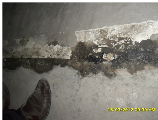
Hình 8. Thấm nền tầng hầm tại MNTC
