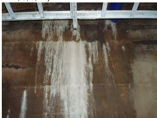
Hình 7. Thấm vách tầng hầm do nứt
