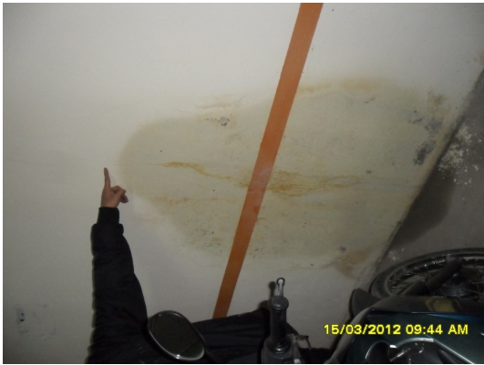
Hình 9. Thấm vách tầng hầm do nứt
