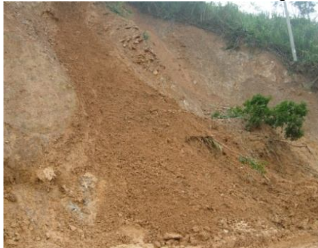
Ảnh 10. Sụt – dòng bùn đất đá tại km 26 + 200 đường TL 10 (25/10/2009)
