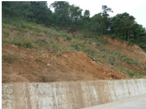
Ảnh 6. Trượt đất đá tại km 931 + 754 đường HCM (ngày 13/01/2008)
