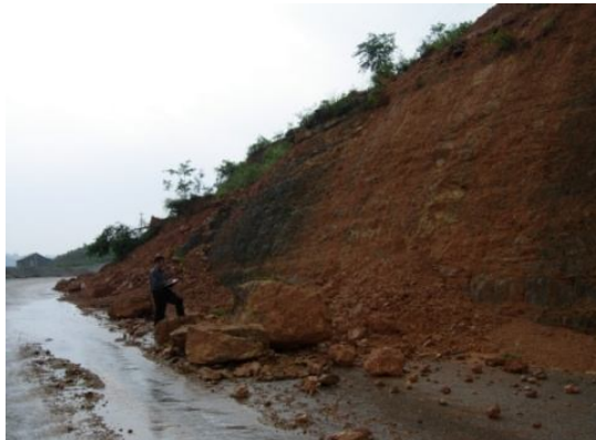
Ảnh 3. Sụt đất đá tại km 126+321 đường 12A (ngày 03/10/2009)
