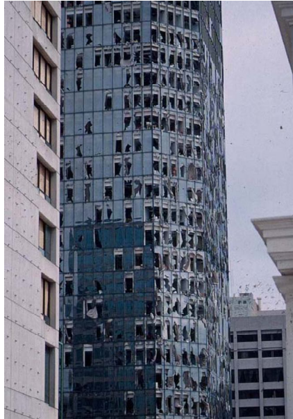
(a) Mặt dựng tường kính của một nhà cao tầng tại Mỹ bị phá hoại
