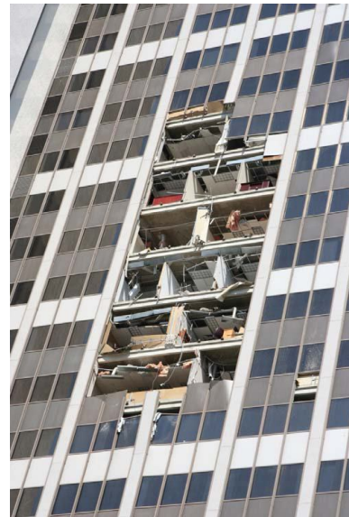
(d) Nội thất của một nhà cao tầng bị hư hỏng sau khi mặt dựng tường kính bị phá hoại
