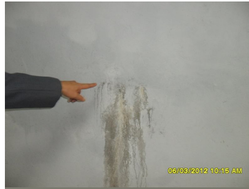
Hình 6. Thấm bể nước tại vị trí thi công mạch ngừng
