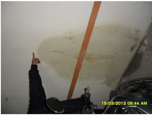
Hình 9. Thấm vách tầng hầm do nứt
