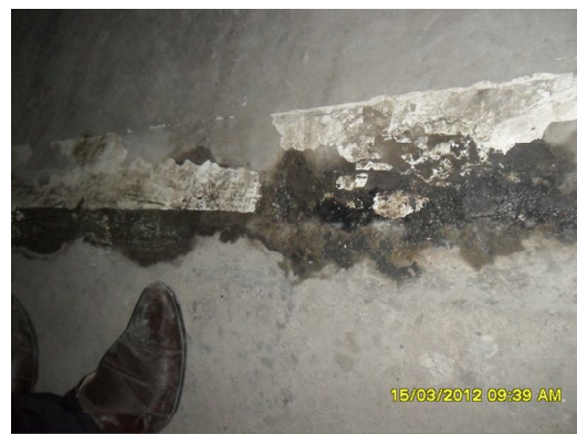
Hình 8. Thấm nền tầng hầm tại MNTC
