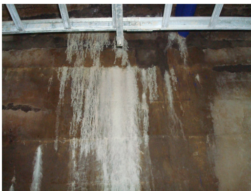
Hình 7. Thấm vách tầng hầm do nứt
