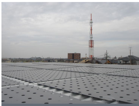
(a) Các tấm che nắng được lắp đặt trên mái của một công trình
