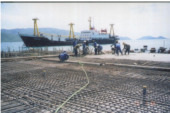
a. Công trình xây mới cầu tàu 20.000 T cảng Nha Trang – Khánh Hoà
