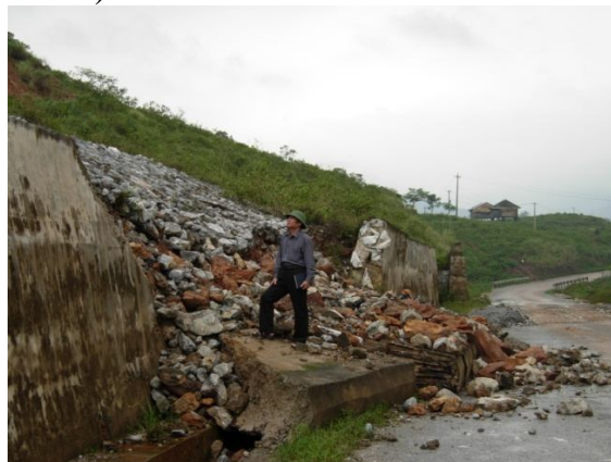
Ảnh 1. Trượt đất đá tại km 127 + 000 đường 12A (03/10/2009)
