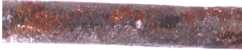
cốt thép 1 (vùng bê tông ẩm)
